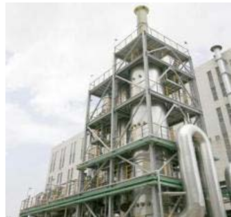
沸石二期工程废弃处理系统外景
